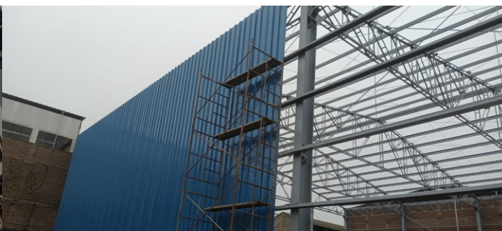
Almacén planta calimod Ate
